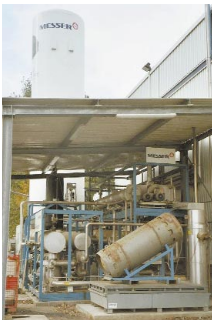
Abb. 4: Durch einen zusätzlich mit flüssigem Stickstoff arbeitenden Nachkühler lässt sich mit einer Rekusolv ® -Anlage neben R11 auch R12 zurückgewinnen
